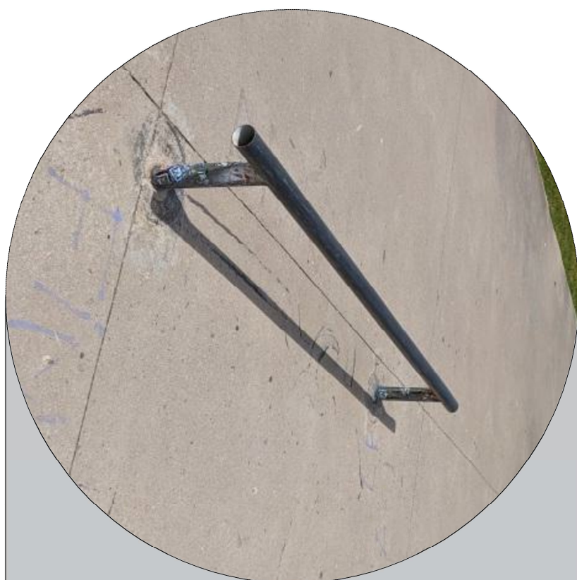
OBSTÁCULO A SER RETIRADO :0,1m³ 1. Retirada de obstáculo de tubo galvanizado
