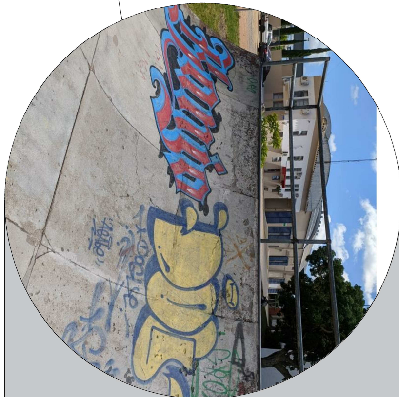
RECUPERAÇÃO RAMPA EXISTENTE 1. Argamassar encontro do concreto do piso com o tubo galvanizado. 2. Recuperação superficial da rampa, que se encontra desgastada e com outras patologias.
