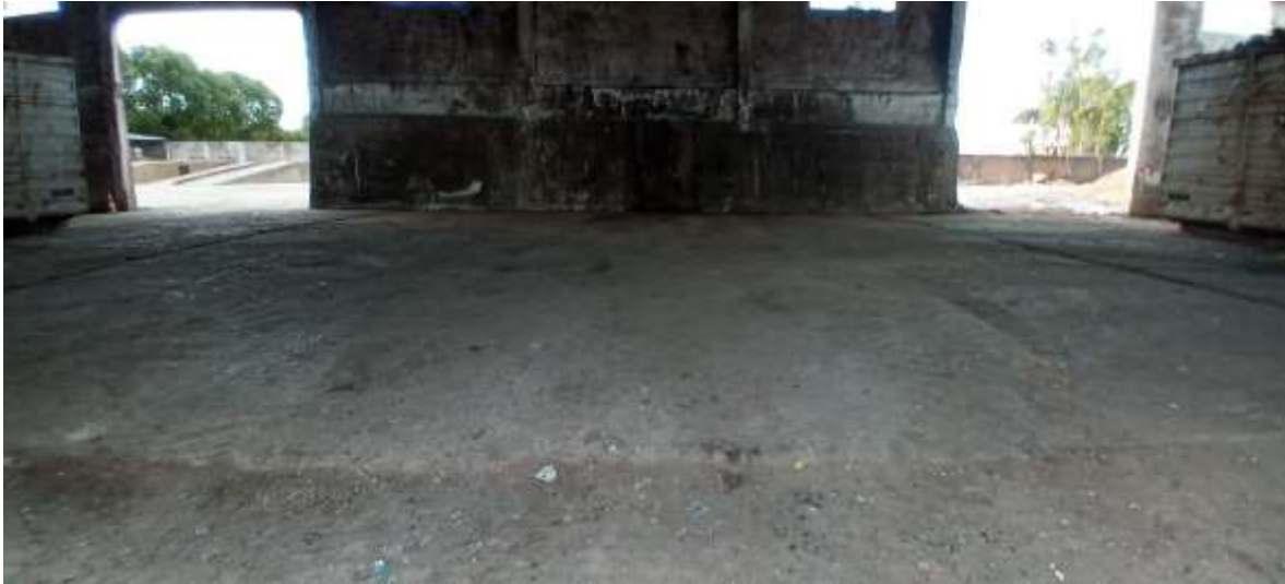
Figura 33. Área da nova Estação de Transbordo do Município de Jaguarão, localizada no Ecoparque Municipal de Jaguarão.
