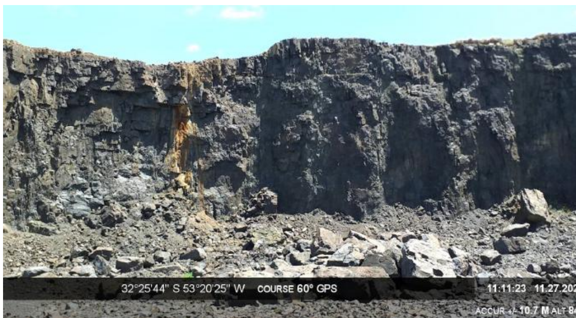
Figura 4 - Talude operacional atual, com ângulo em torno de 90° e altura variando entre 8 e 14 m.
